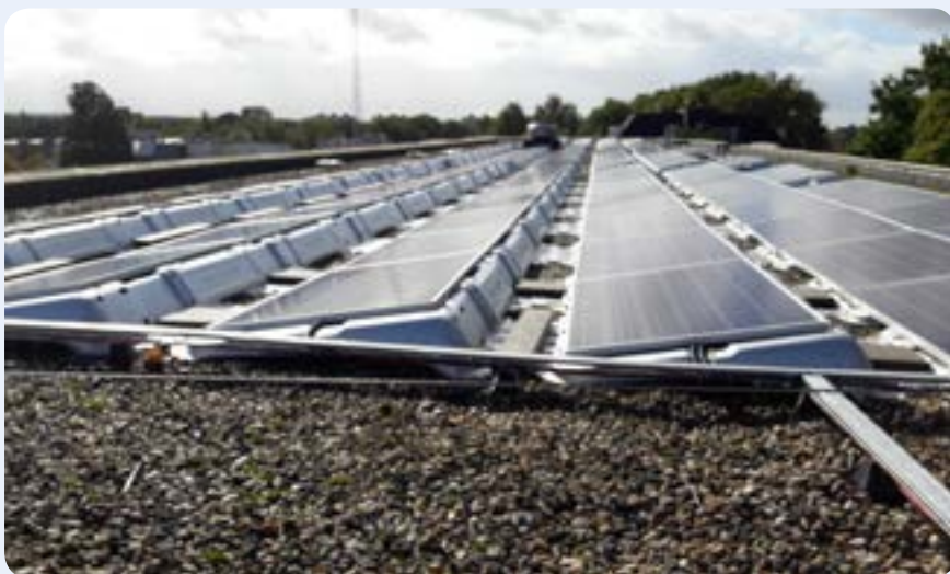
Zonnepanelen dak gemeentehuis
